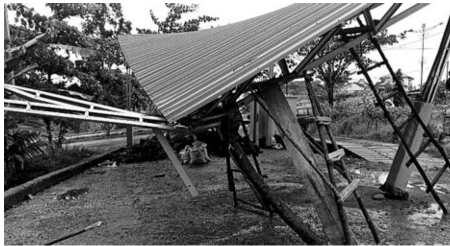
BADAI : Atap Alun-alun Taman Kota yang roboh. Begitupun pohon besar di pinggir jalan lintas Bengkulu-Seluma tumbang menutup jalan.
