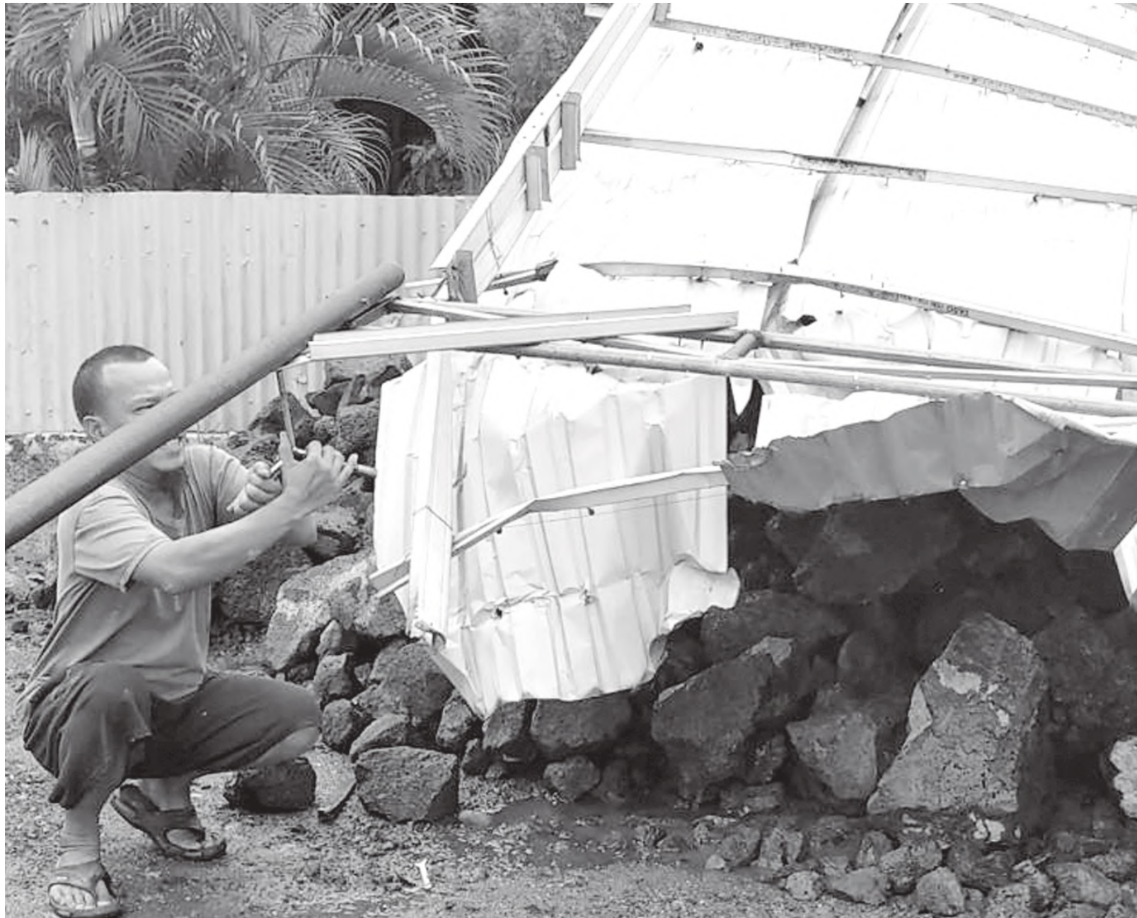
RUSAK: Inilah salah satu bangunan yang atapnya rusak yang disebabkan oleh hujan dan angin kencang.
