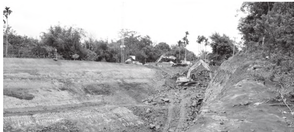
TOL: Pengerjaan pembangunan jalan tol yang berada di zona dua yakni di Desa Jumat hingga Desa Penanding.
